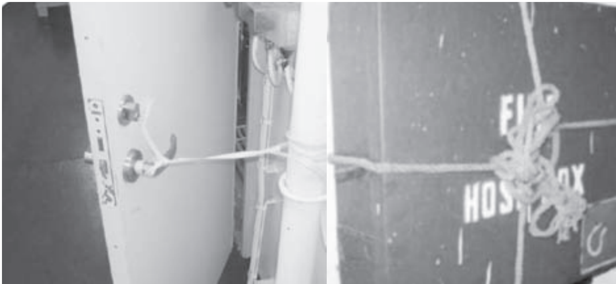
شرایط نامناسب بستن درب جعبه لوله‌های اطفاء حریق و مهار نامناسب درب ضدآتش
